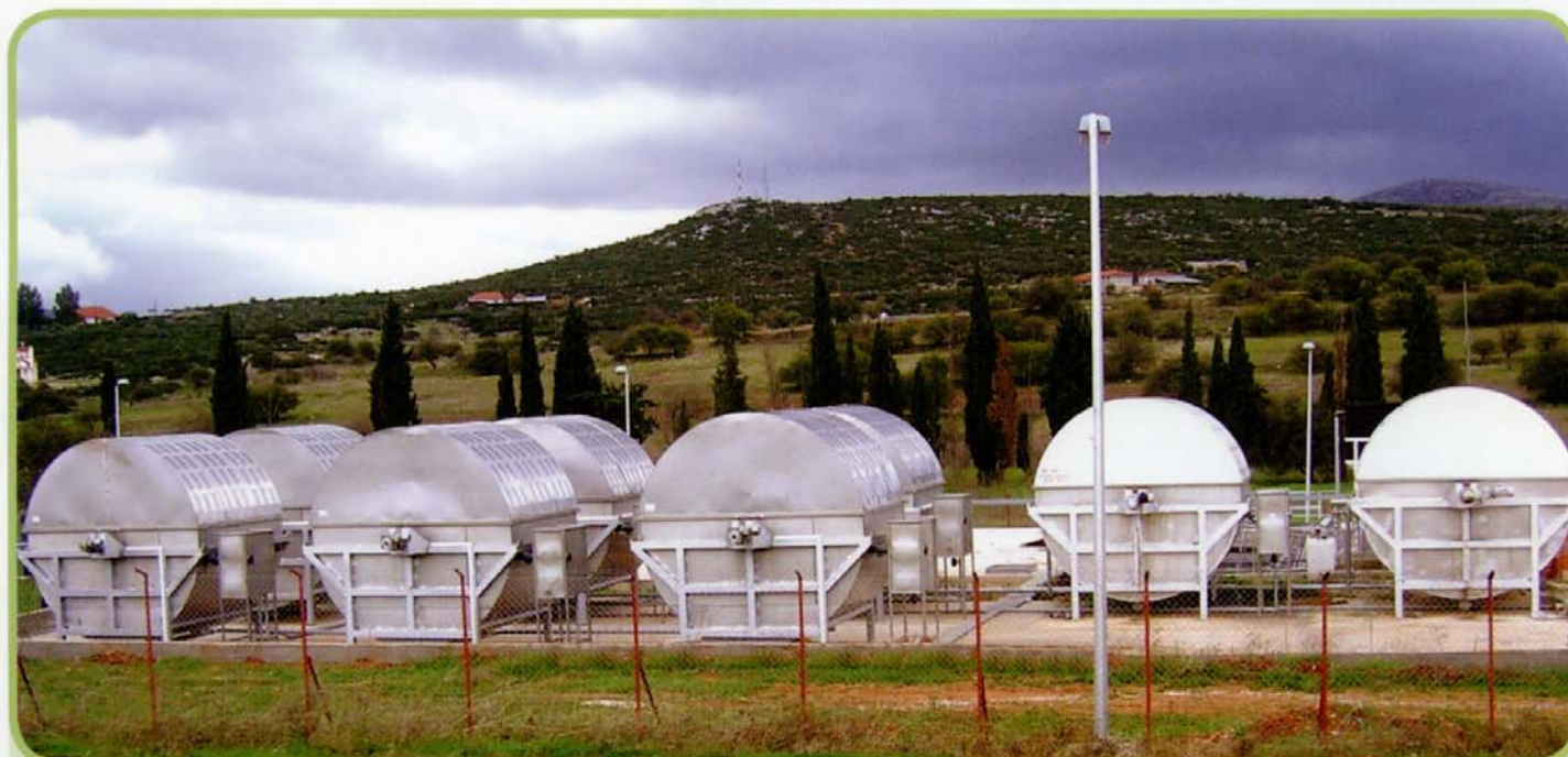
Μονάδα Βιολογικού Καθαρισμού
