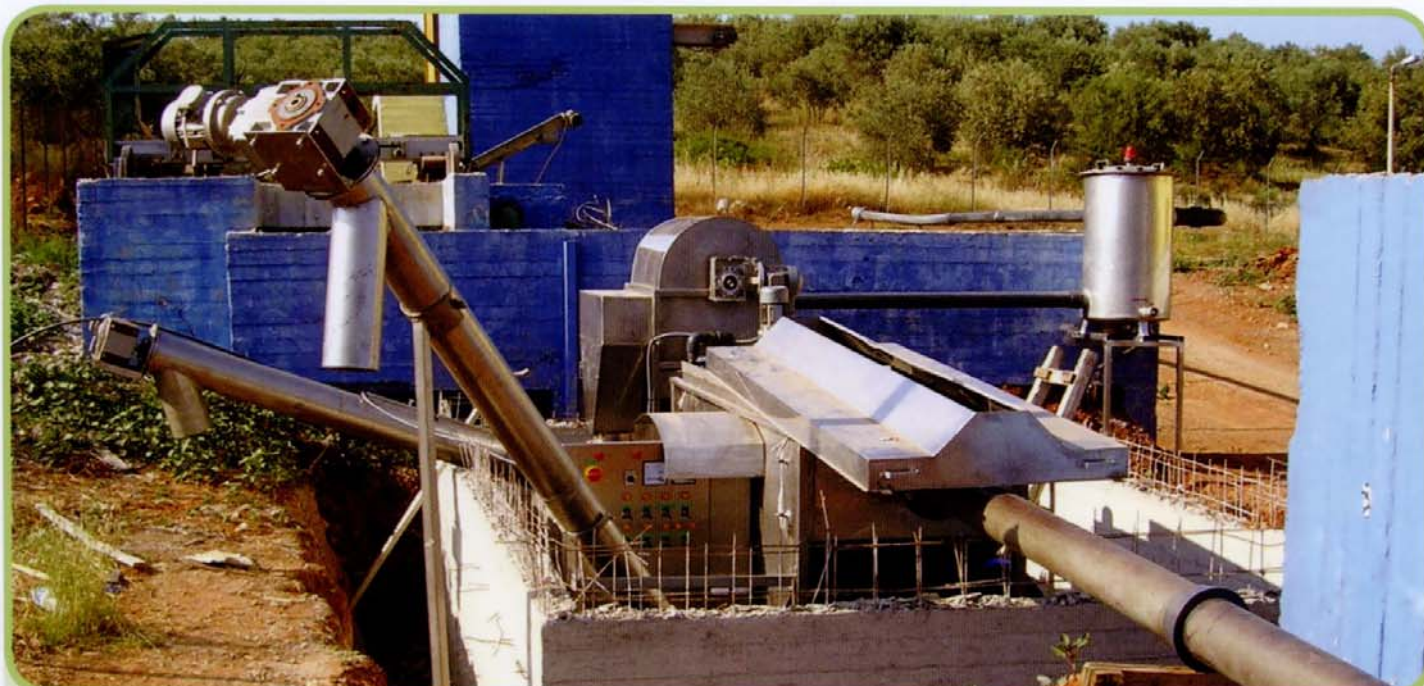
Μονάδα Προεπεξεργασίας Λυμάτων
