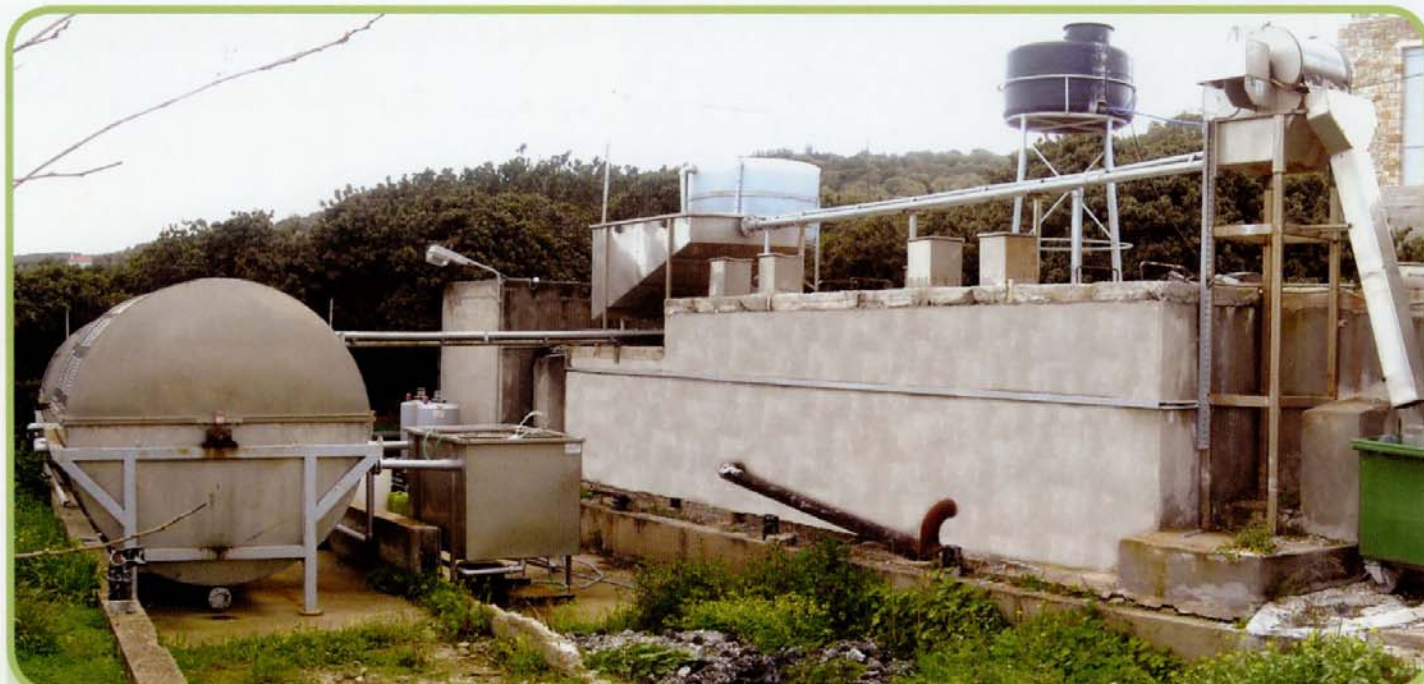
Μονάδα Βιολογικού Καθαρισμού
