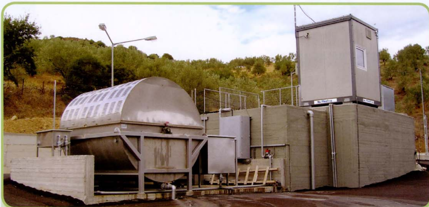
Μονάδα Βιολογικού Καθαρισμού
